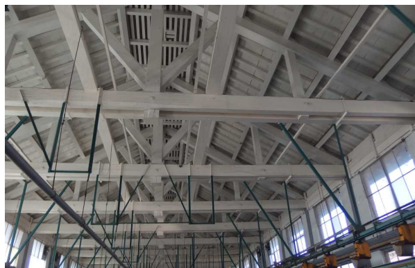
写真-3 繰糸所の梁の状況(筆者撮影)
